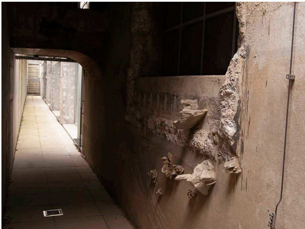
In situ Ausblühungen , 2018 Zement, Armierungseisen, Ton Luftschacht Hochschule der Künste Bern
