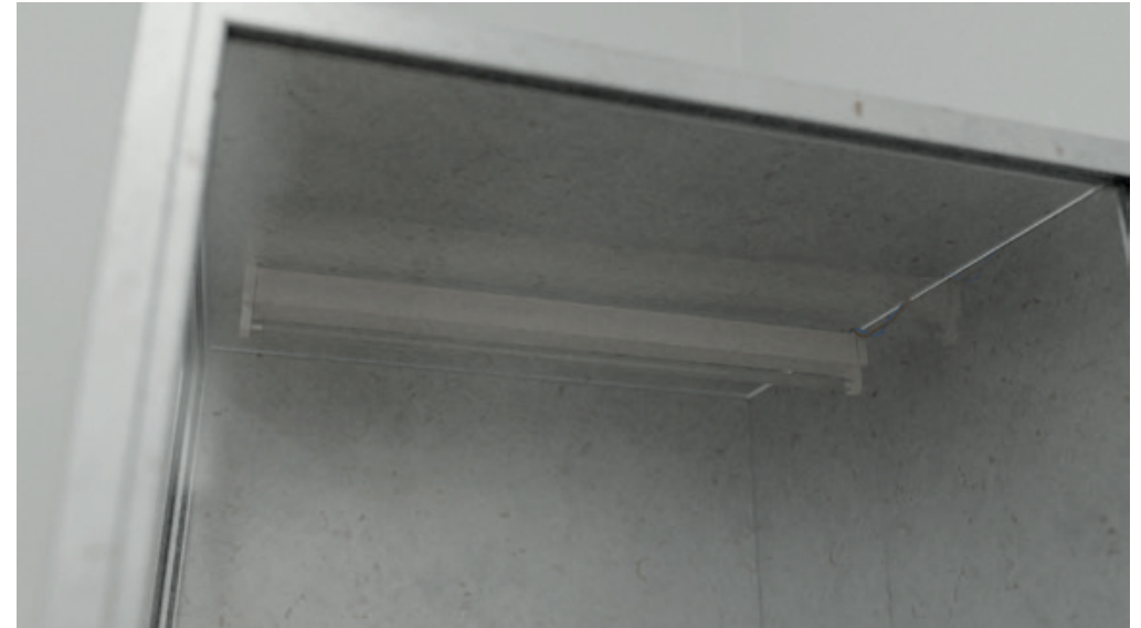
An der Decke der Kabine ist eine Halterung mit einer nicht leuchtenden Neon-Röhre montiert
